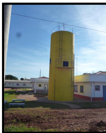
i) Reservatório R-6 (15m 3 )
